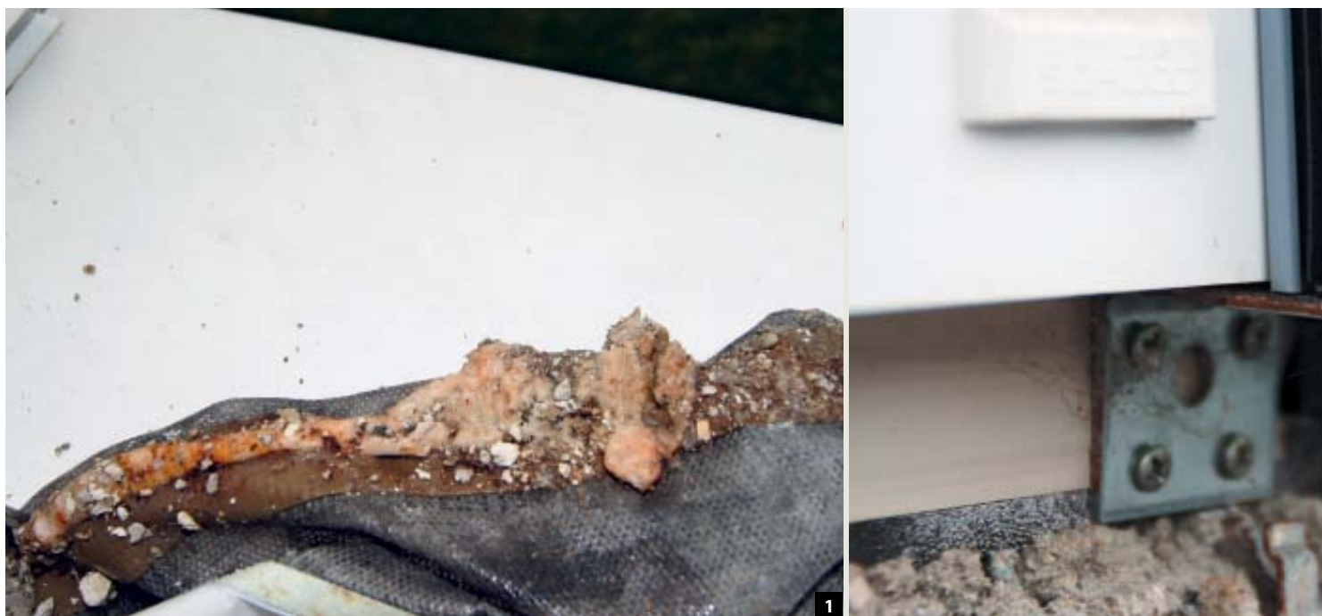
Abb. 1–3: Abdichtung, dauerhafte Lastabtragung und Befestigungspunkte sind die drei Aspekte, bei denen beim Fensteraustausch am häufigsten Fehler passieren.
