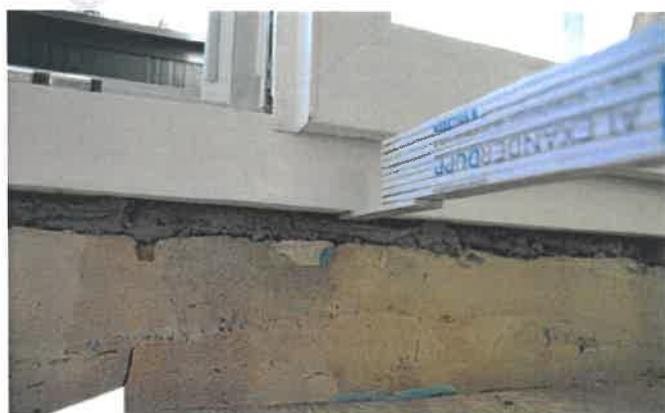
Unterer Anschluss eines Fensterrahmens auf einen Mauersockel. Nach Abnehmen des PVC-Deckbrettes ist lediglich Polyurethan-Ortschaum festzustellen. Der innere Anschluss fehlt komplett.
